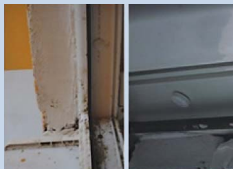
Рисунок 5. Утечка воздуха между оконными рамами и ограждающей конструкцией
